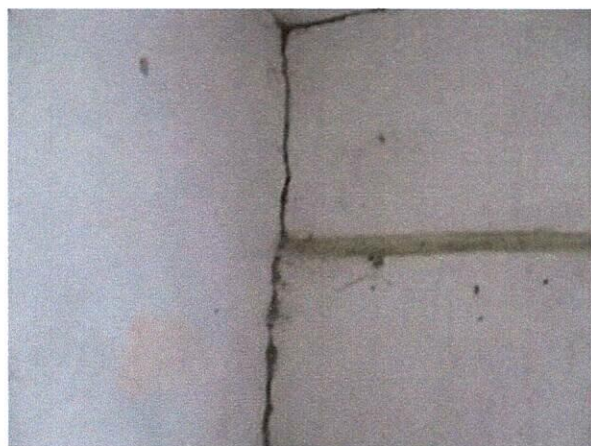
Trhlina v komoře
